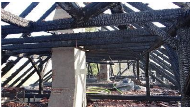
Zničené podkroví zámku.
